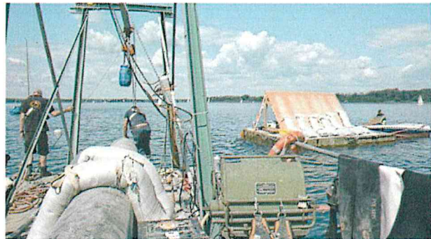
Vorbereitung zum Versenken der Riesenweißwürste: Auf einem Stück Ringkanal bekommen die 400-Kilo-Kunststoffsäcke voll Zementbeton ihre Passform, bevor sie vom selbst gebauten Kran an den Haken genommen und am Stahlseil zum Bestimmungsort hinabgelassen werden. Rechts kommt auf einer Plattform aus dem Hafen der Chiemsee-Schiffahrt schon Nachschub. (1) / db (1) / AUV (2) FOTOS BERGER
