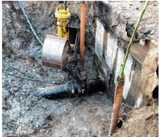
Schäden am Ringkanal müssen oft sofort behoben werden. Auch ein Entlüftungsrohr am Ufer der Herreninsel hat der Abwasser- und Umweltverband ersetzen müssen (unser Bild). Das Rohr hat den Zweck, dass Gase aus der im See verlegten Ringleitung an Land entweichen können. Den Schaden und Bruch des Rohres bemerkten die Mitarbeiter, weil das Abwasser auf das Land drückte. ümmler FOTO TH
